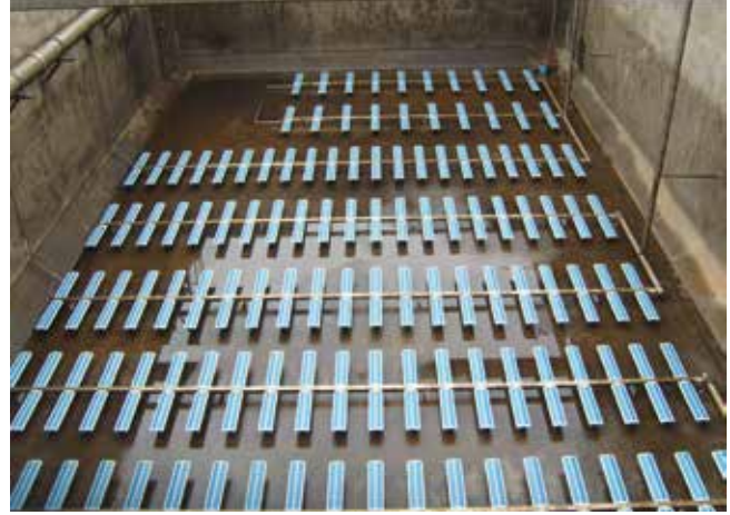
Die ELASTOX®-P Plattenbelüfter werden in der Regel paarweise an den Belüftungsgittern montiert.
